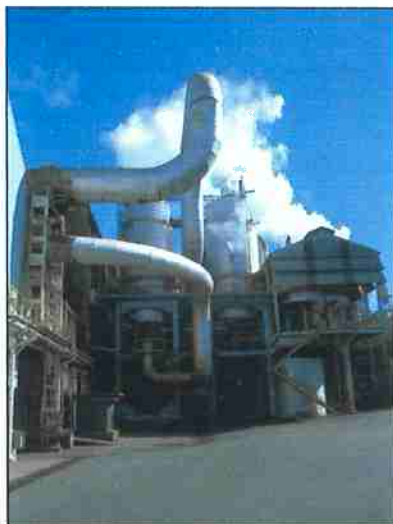
Figura B.10 – Conjunto de evaporadores da Usinas Iracema.
