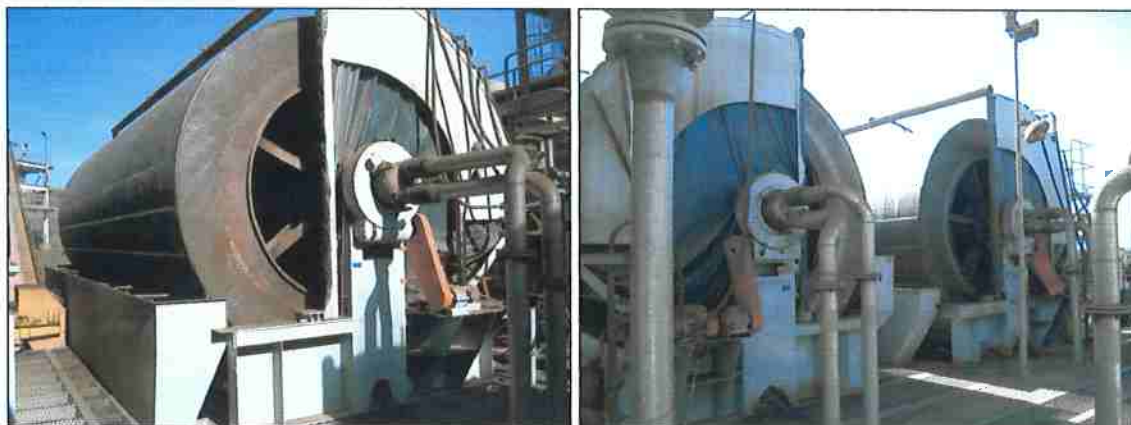
Figura B.9 – Vista dos filtros rotativos à vácuo
