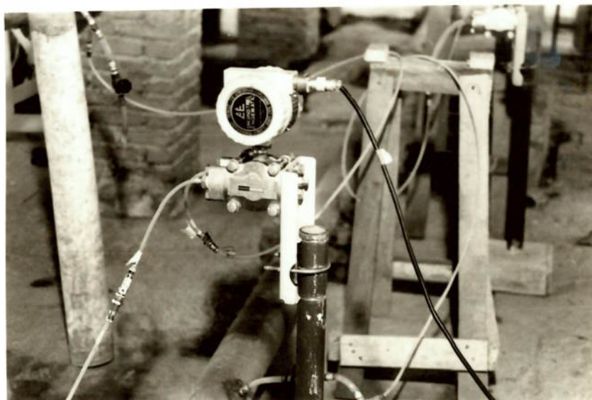
Foto (III.2) O transdutor de pressão. Observe-se à esquerda as conexões às tomadas de pressão e a direita (cabo preto) a conexão ao sistema de aquisição de dados.
