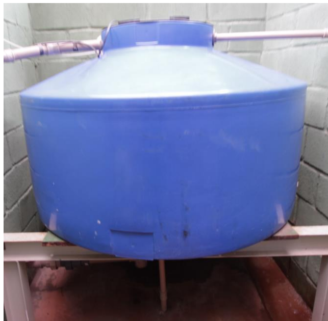
Figura 13 Caixa de Equalização
