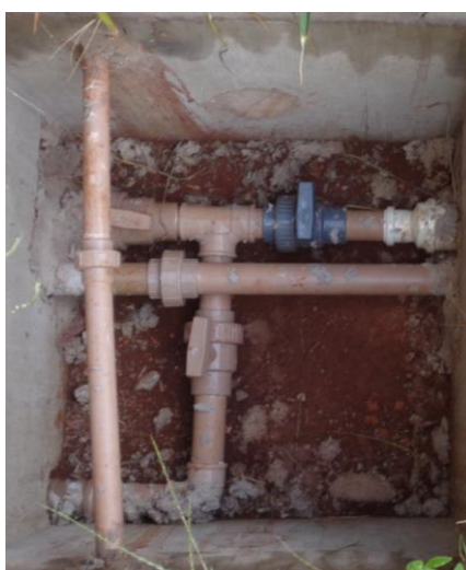
Figura 11- Caixa de Registros
