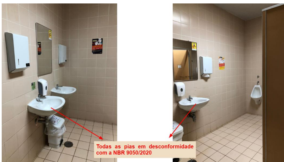
Figura 34 – Banheiros masculino e feminino destinados a pacientes ambulatoriais e seus cuidadores. Ribeirão Preto, São Paulo, 2023.
