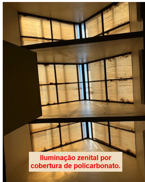
Figura 25 - Cobertura em policarbonato responsável por desconforto térmico. Ribeirão Preto, São Paulo, 2023.
