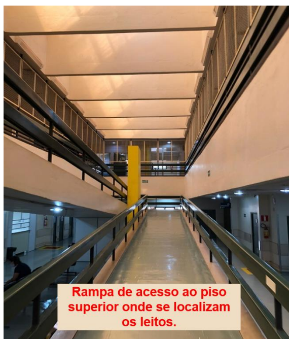
Figura 32 – Circulação vertical (rampa) como fator de risco ergonômico. Ribeirão Preto, São Paulo, 2023.
