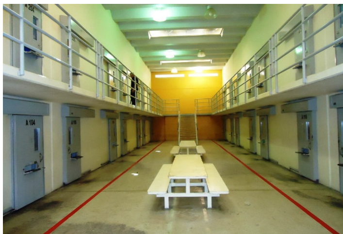
Figura 148: Imagem de uma das alas de celas e espaço de vivência coletiva da Penitenciária Regional de Cachoeiro do Itapemirim/ES (Fonte: OAB de Cachoeiro do Itapemirim/ES, disponível em http://www.oabcachoeiro.com.br/noticia39.php , acesso em 29/06/2019, às 08:24h).
