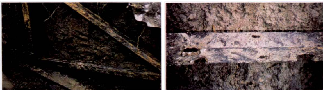
Figura 45 - Corrosão em Grelhas. Fonte: [35]
