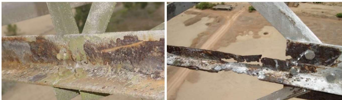
Figura 43 - Corrosão em Estruturas. Fonte: [31]
