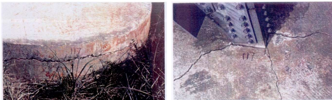
Figura 44 - Trincas na Fundação. Fonte: [35]
