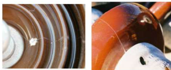
Figura 41 - Perfurações em Isoladores de Disco de Porcelana. Fonte: [4]
