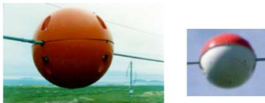
Figura 12 - Esferas de Sinalização Aérea. Fonte: [11]
