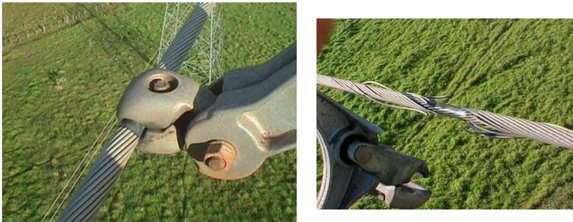
Figura 35 - Danos em Cabos Condutores em Interface com Espaçadores. Fonte: [31]
