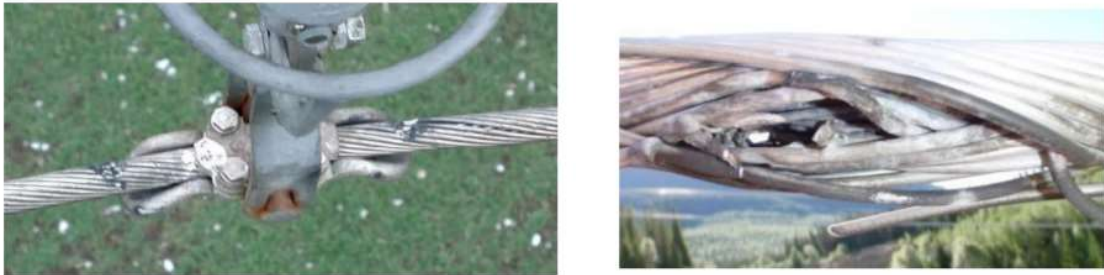
Figura 36 – Cabos com Sinais de Descargas. Fonte: [30]
