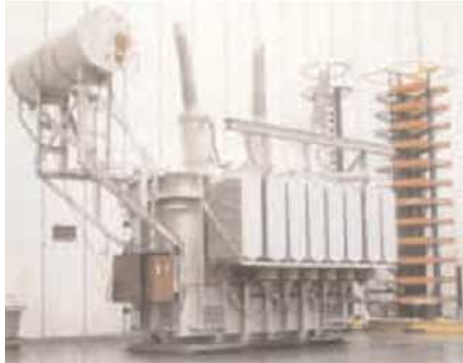
Figura 1: Transformador de potência em óleo isolante (SIEMENS, 2001).
