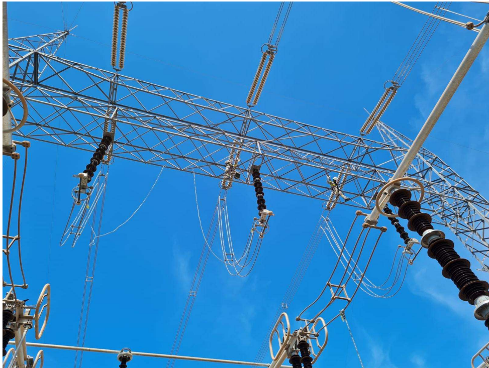
Figura 4.10 – Detalhes do processo de instalação do protótipo do sensor no arranjo das chaves seccionadoras (III).
