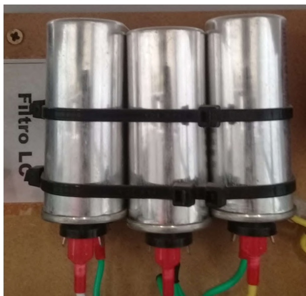
Figura A.4: Capacitor do filtro LC de saída.
