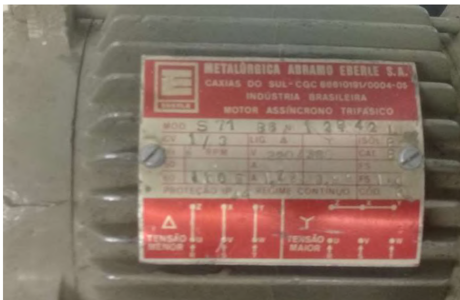
Figura 5.19: Carga indutiva – Motor de Indução Trifásico (dados de placa).
