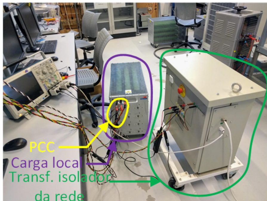
Figura 5.2: Bancada utilizada para testes com a microrrede: carga conectada ao PCC e o ponto de conexão com a rede.
