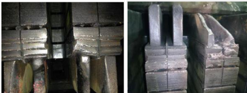
Figura 24: Pontos de Curto-circuito identificado nas inspeções visuais. Adaptado de (SILVA; SILVA; SANTOS, 2017)
