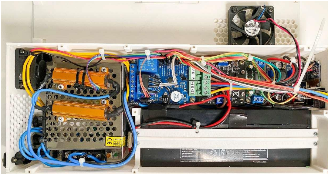
Figura 5.12: Componentes instalados na fonte.
