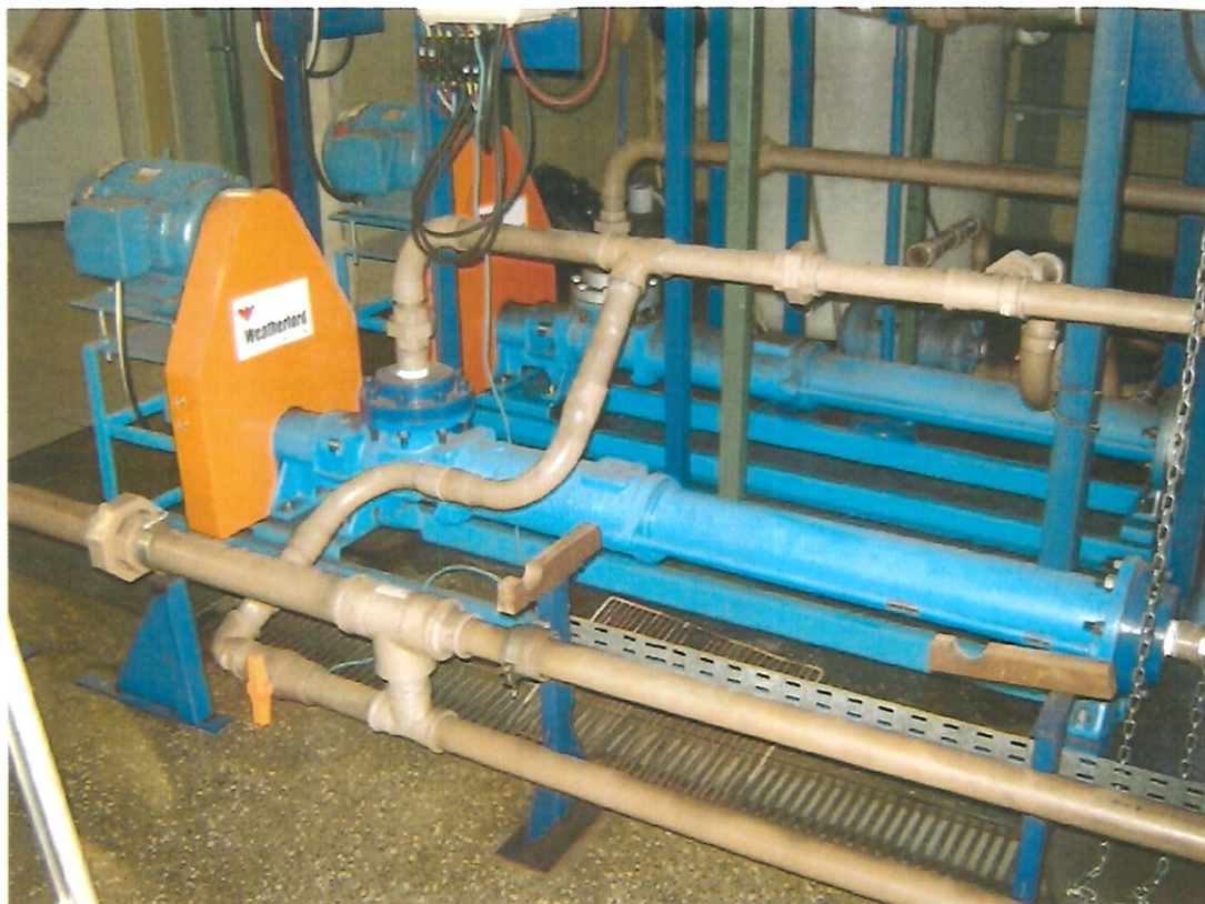
Figura 4.5. Bomba helicoidal de alimentação de água, ao fundo, bomba helicoidal de alimentação de óleo.
