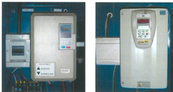
Figura 4.4. Inversores de Frequência.
