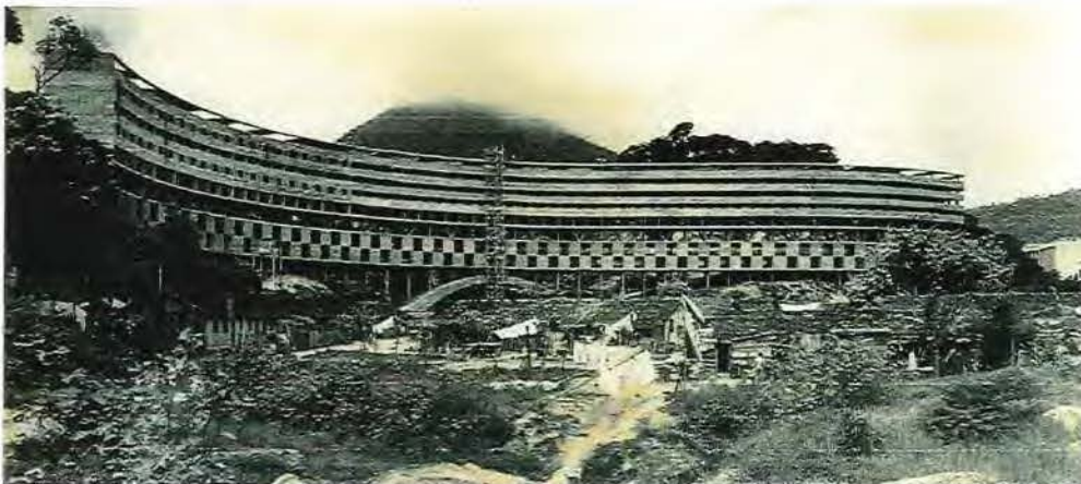
Conjunto Residencial Marquês de São Vicente: bloco A em construção vendo-se os blocos residenciais do Parque Proletário nº1 em construção (DHP, 1961:s.p.)
