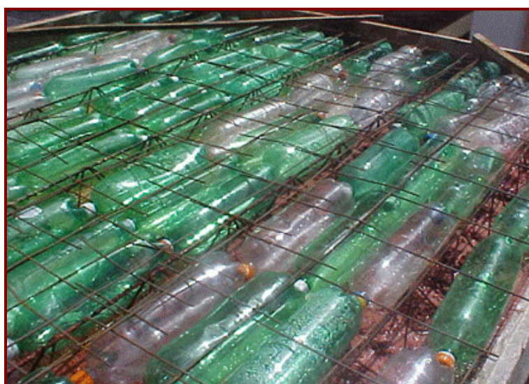
Foto 2 – Laje preparada com treliças, elemento de enchimento (garrafas PET) e armadura de distribuição, pronta para receber o concreto
