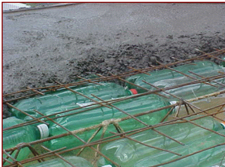
Foto 3 – Laje treliçada, com execução da capa de concreto. Fonte: Coelho, F.C.A (2004b).
