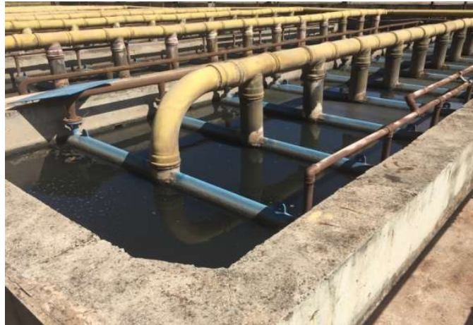
Figura 26 - Vista de um Reator UASB da ETE Laranja Azeda
