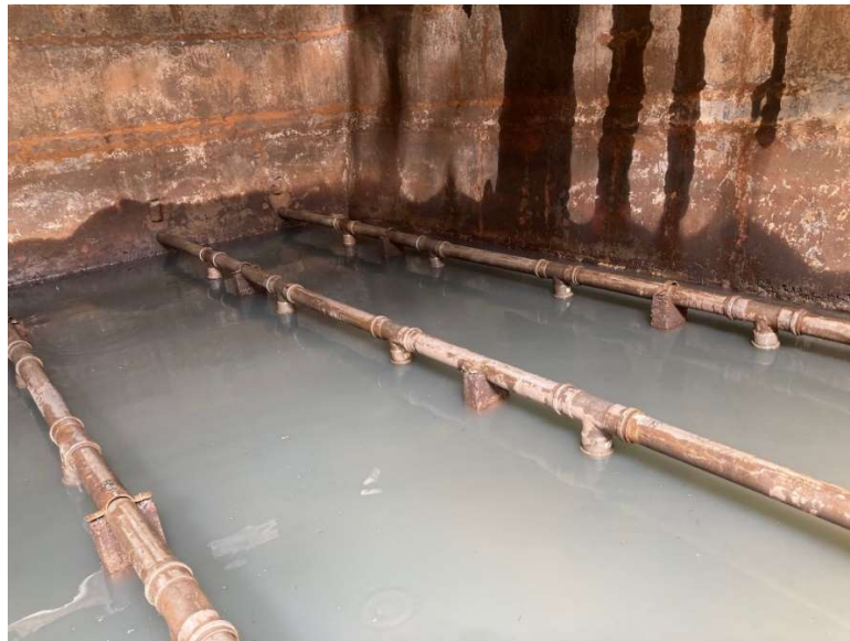
Figura 20 – Distribuição interna de um reator anaeróbio da ETE Laranja Azeda
