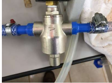
Figura 41 - Válvula reguladora de pressão
