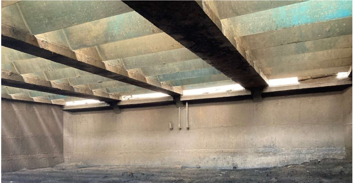
Figura 22 – Visão dos separadores trifásicos do reator anaeróbio da ETE Laranja Azeda – Vista interna.
