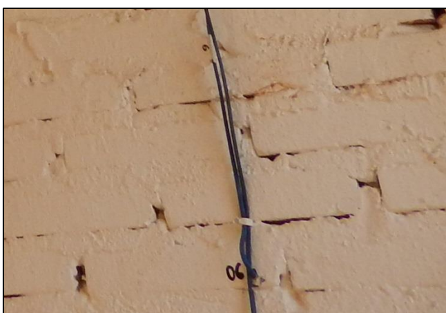
Figura 11: Imagem do termopar colocado sob a parede. Fonte: o autor (2018)
