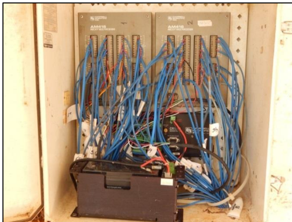
Figura 9: Conexão dos termopares ao Data logger. Fonte: O autor (2018)
