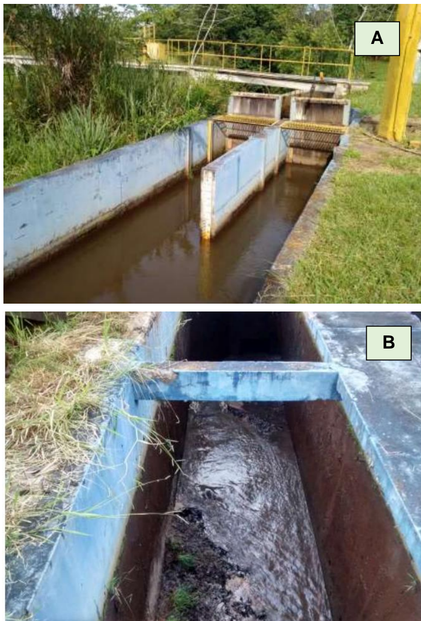
Figura 7 - A) – Canaleta de entrada da Captação do Ribeirão do Feijão (vista interna) B) Chicana para redução da velocidade da água na captação do Ribeirão do Feijão.
