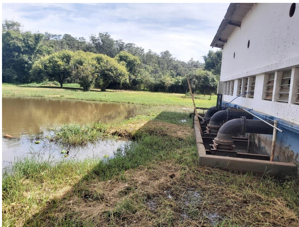
Figura 4 – Reservatório de acumulação e poço de sucção da captação do Espraiado.
