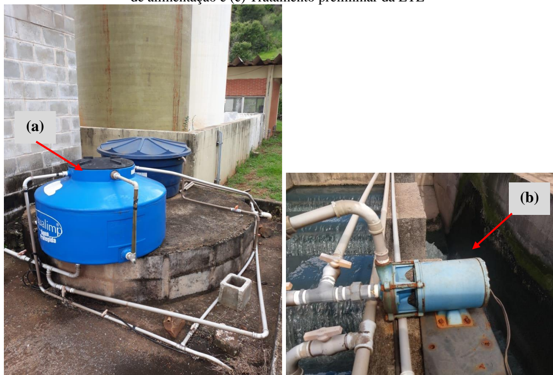
Figura 4.6 Configuração da alimentação do RLF: (a) Caixa de alimentação, (b) Bomba centrífuga de alimentação e (c) Tratamento preliminar da ETE
