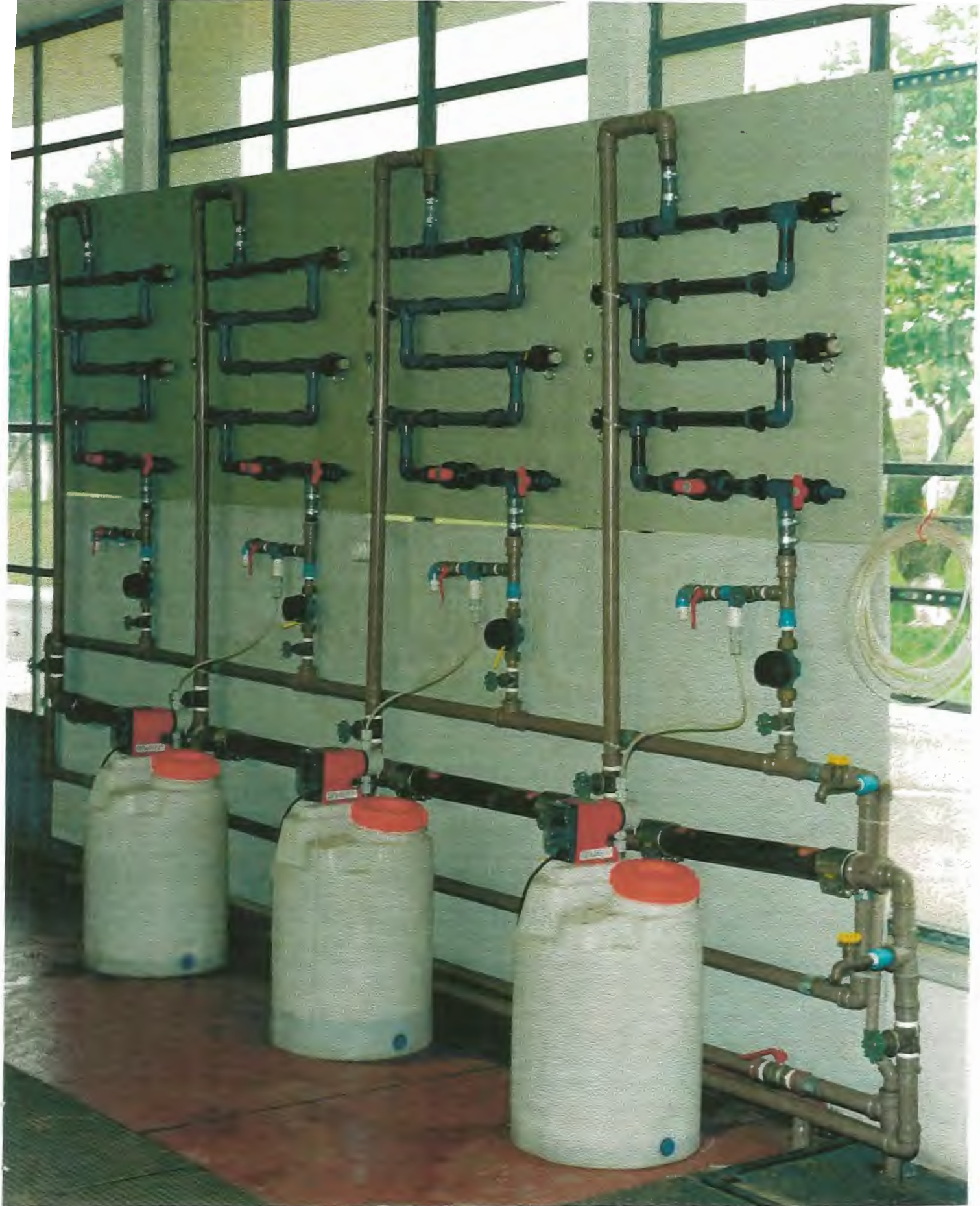
FIGURA 4.4 : Fotografia da instalação piloto 1 - Fase II
