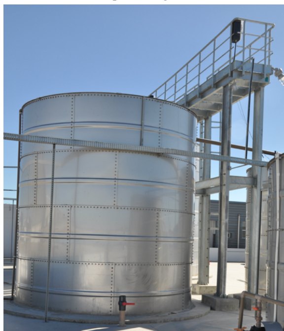
Figura 12 – Vista lateral de um tanque de regularização de vazão em chapa de aço
