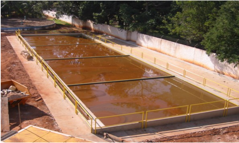
Figura 19 – Leitos de drenagem em operação (ETA de Monte Aprazível – SP)
