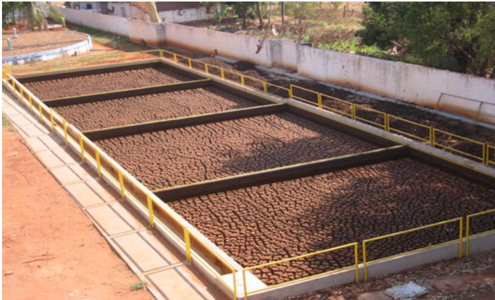
Figura 20 – Leitos de drenagem com o lodo drenado (ETA de Monte Aprazível – SP)
