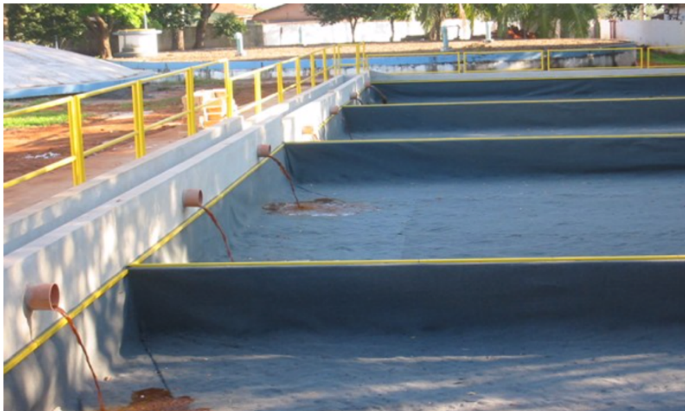
Figura 18 – Leitos de drenagem recebendo lodo (ETA de Monte Aprazível – SP)
