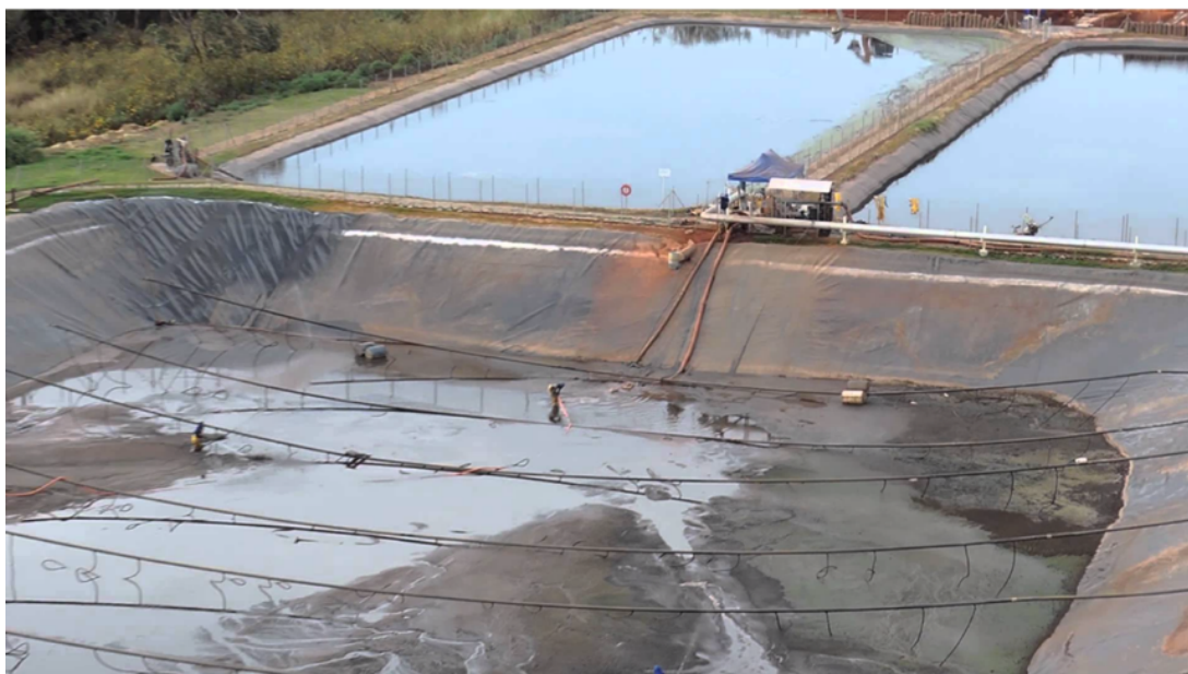
Figura 23 – Lagoas em operação ao fundo e lagoa em manutenção à frente
