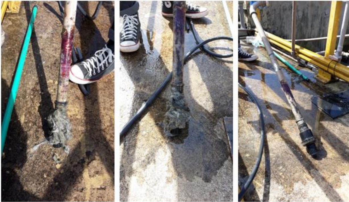
Figura A7: Limpeza do pé de crivo da bomba instalada no tratamento preliminar da ETE.
