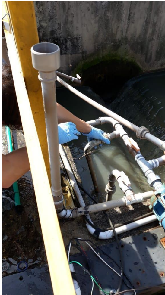
Figura A6: Retirando o pé de crivo da bomba instalada no tratamento preliminar da ETE.
