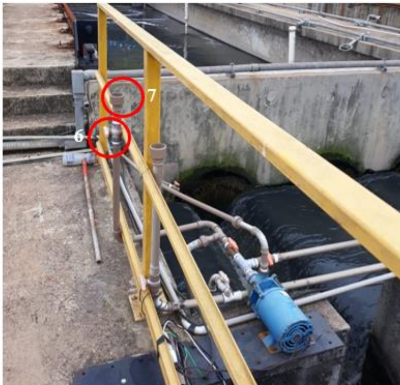
Figura A5: Bomba centrífuga instalada no tratamento preliminar da ETE de São Carlos – SP.
