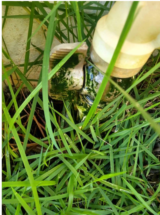
Figura 82 - Vazamento identificado em campo.
