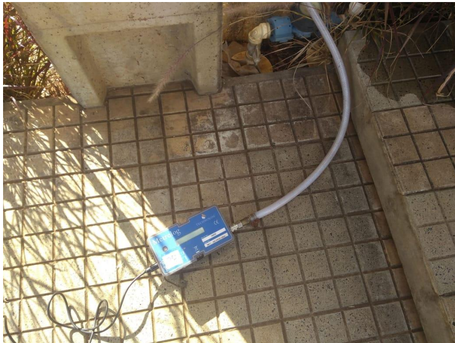
Figura 18- Medidor de pressão conectado ao cavalete.
