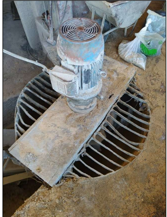
Figura 24: Tanque de mistura
