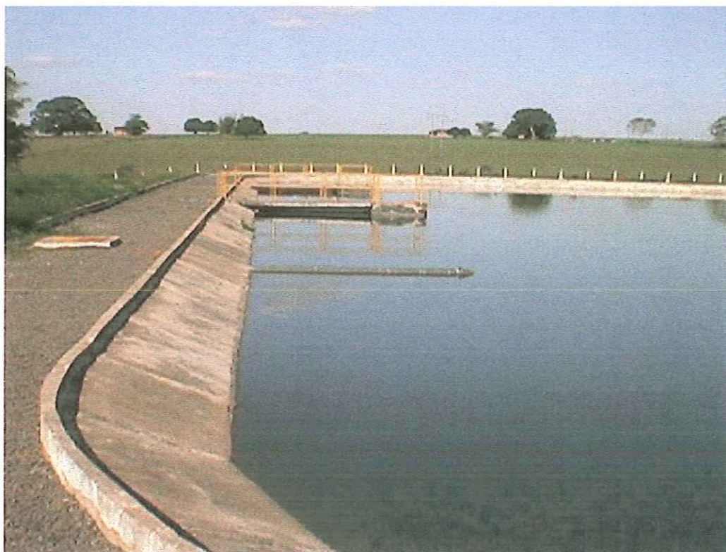
FIGURA 5 – Coroados: vista da saída do sistema de tratamento
