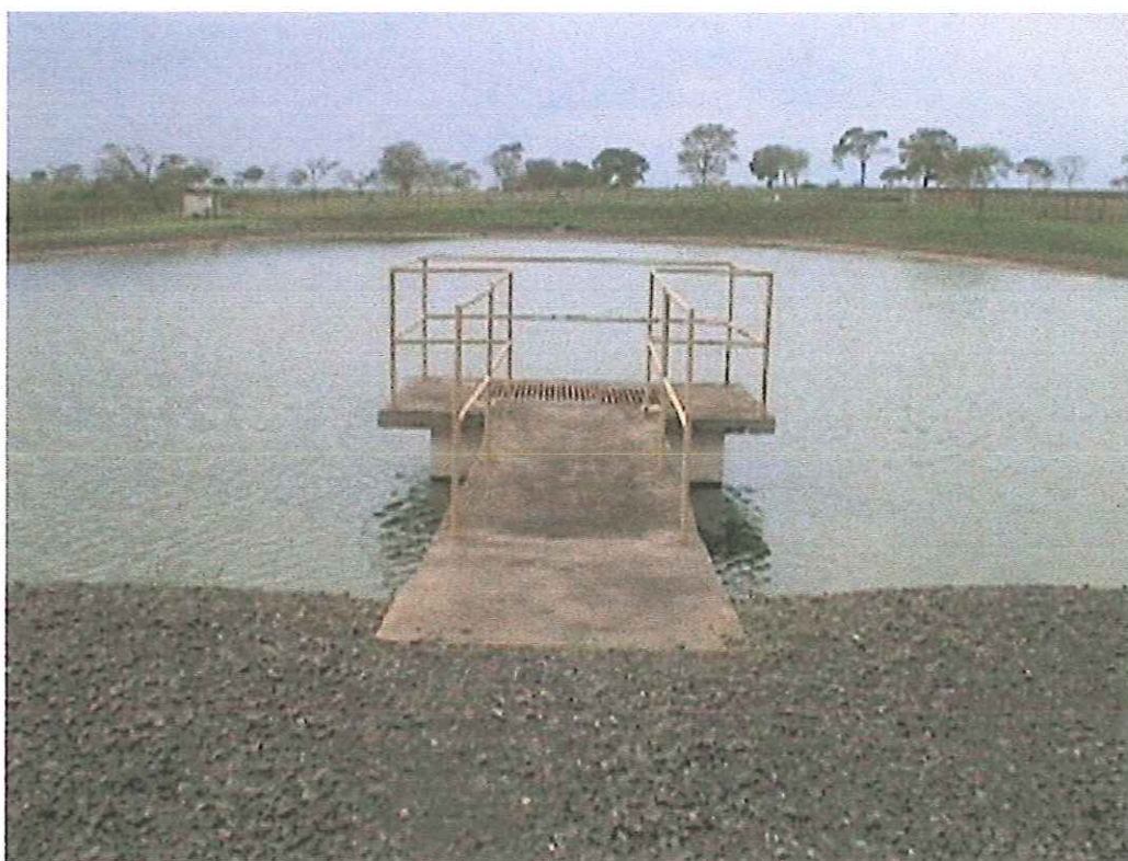
FIGURA 9 – Planalto: vista da saída do sistema de tratamento
