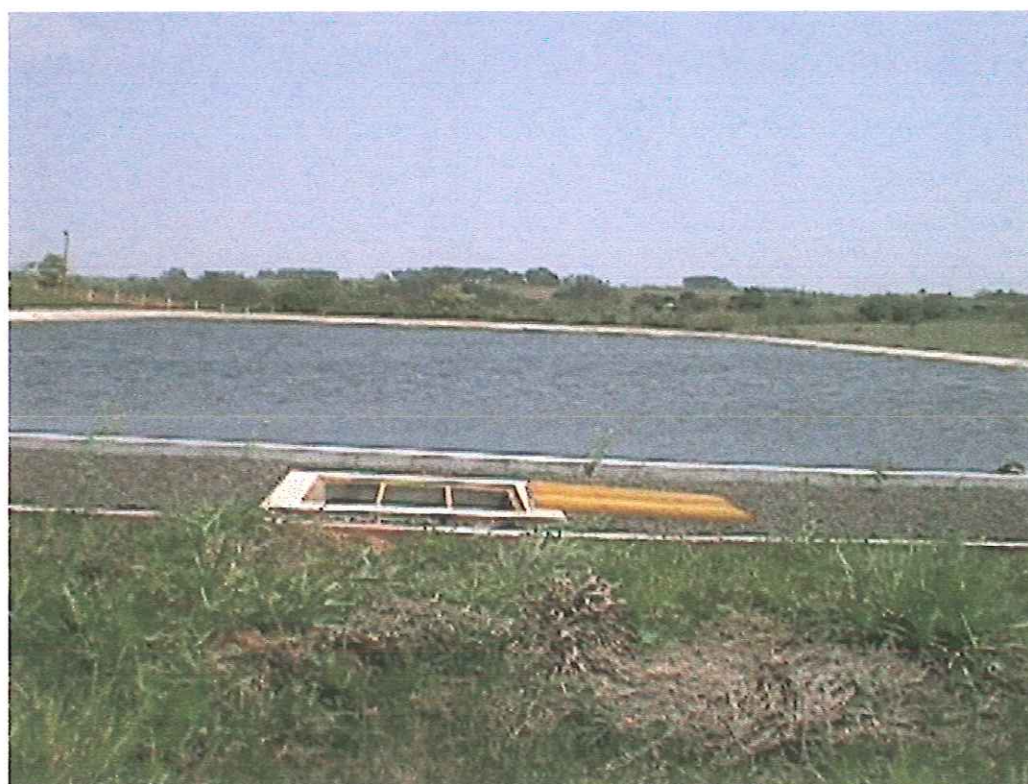
FIGURA 15 – Pongá: vista da lagoa facultativa secundária
