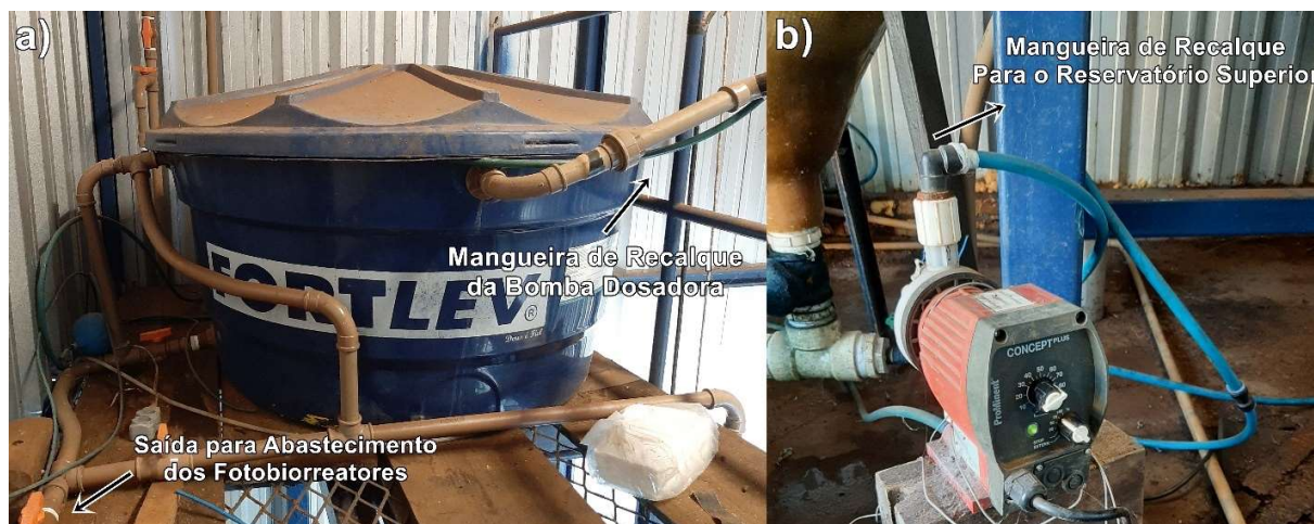
Figura 07 – (a) reservatório superior instalado para alimentação dos fotobiorreatores e (b) bomba utilizada no recalque de esgoto sanitário bruto
