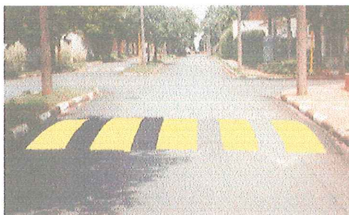
FIGURA 20b: Sinalização de lombada implantada em São Carlos-SP Fonte: FERRAZ (1997)
