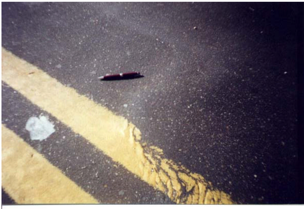
Figura 3.6: Detalhe do afundamento no recapeamento defeituoso
