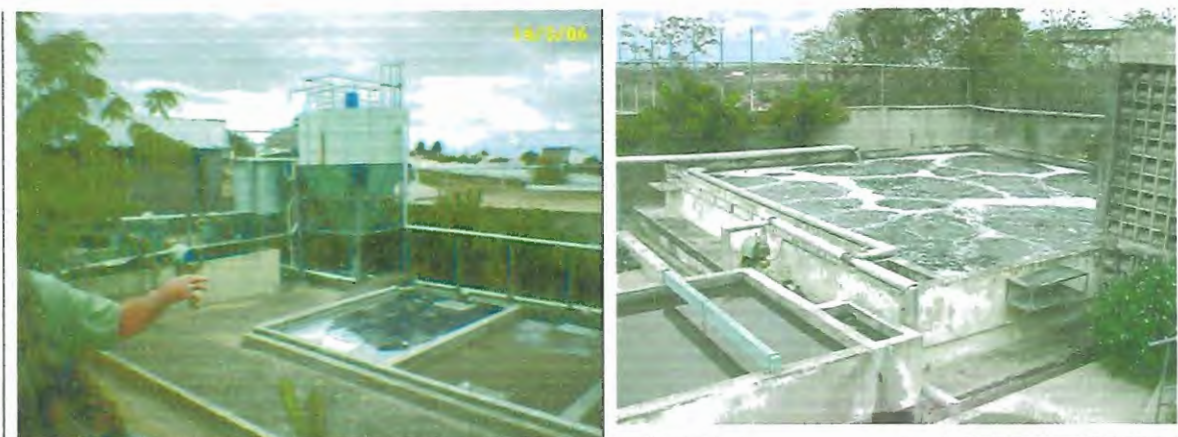
Figura 27 - Estação de Tratamento de efluentes.
