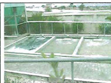
Figura 22 - Lagoas de decantação.
