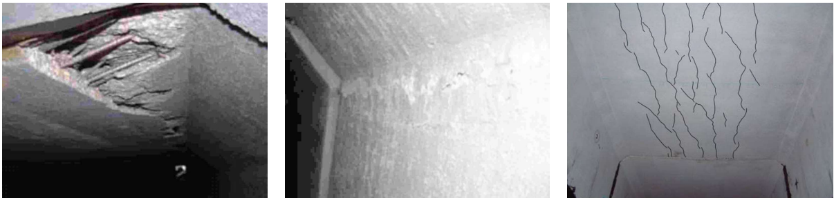
Figura 2.6 Danos observados em galeria sob aterro de 35 m de altura
