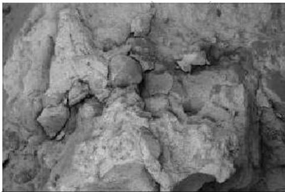
(a) Fissuras na interface pasta/agregado. Fonte: Melo(2000)
