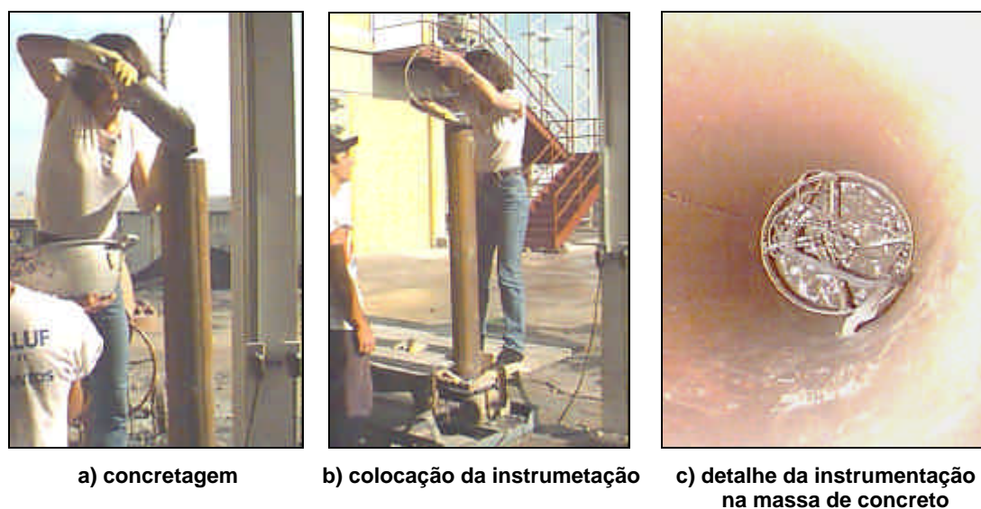
FIGURA 7.15– LANÇAMENTO DO CONCRETO E POSICIONAMENTO DOS EXTENSÔMETROS NO INTERIOR DO PERFIL TUBULAR
