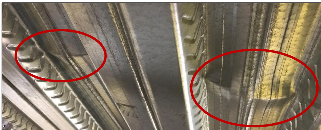
Figura 3.6 – Ondulações nas ondas altas da fôrma de aço no “estágio final de comportamento”
