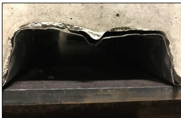
(b) Deformação da fôrma de aço e separação
