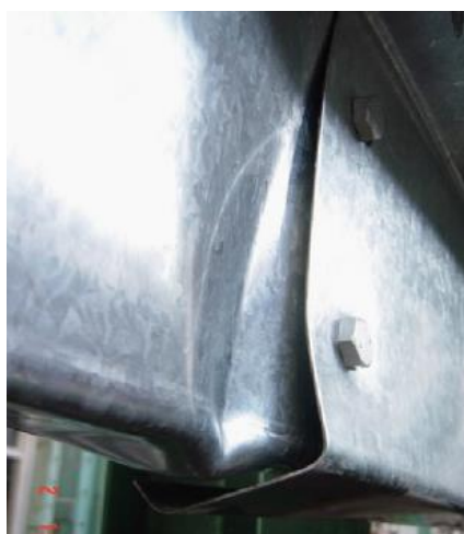
Figura 2.2 – Modo de falha no fim da ligação caracterizado pela separação das mesas adjacentes dos perfis das terças contínuas por meio de transpasse.
