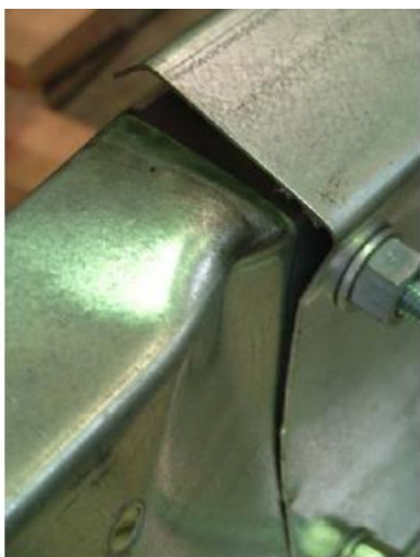
a) Falha local-distorcional
