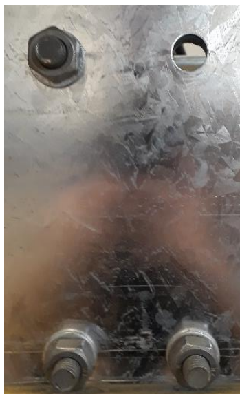
Figura 5.9 – Diferença relativa entre o posicionamento dos furos na região da ligação.
