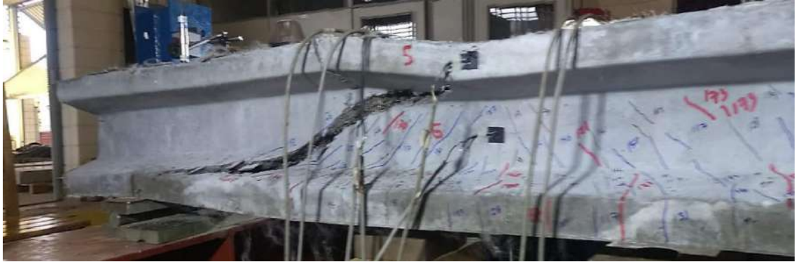
Figura 7.13: Ruptura da viga UHPFRC-P-Flex-Cis
