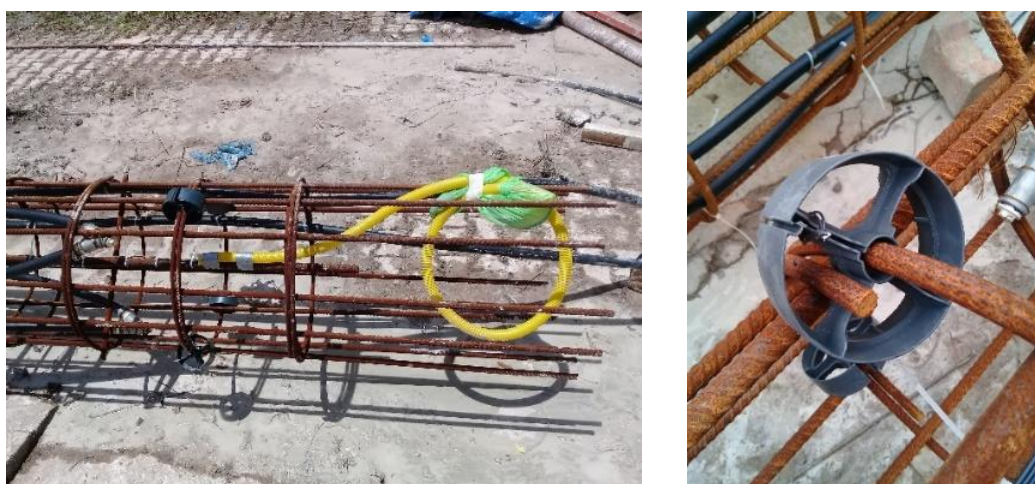
Figura 3.27: Preparação das armações para a execução das estacas (a) proteção dos cabos com conduítes e (b) reforço dos roletes com arame.
