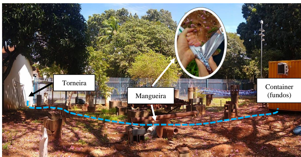
Figura 3.61: Localização e isolamento térmico da mangueira que alimentava o reservatório a montante.
