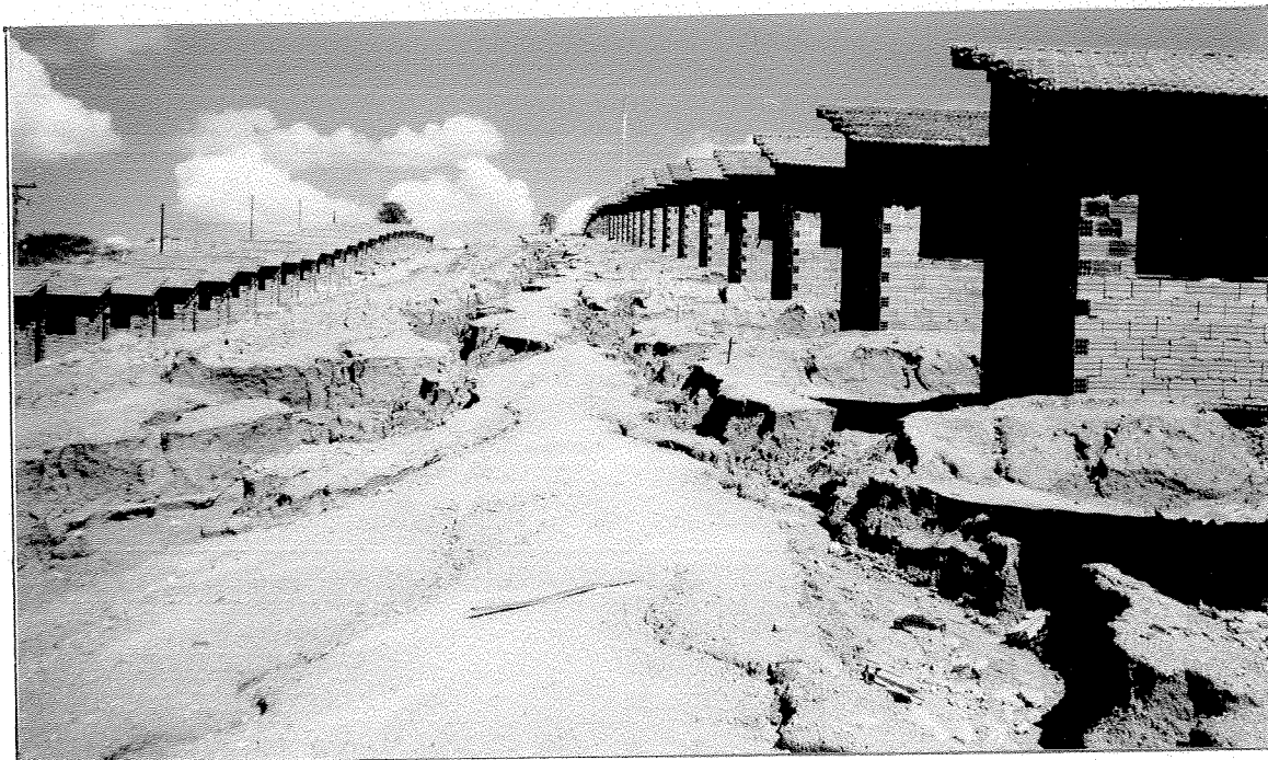
Fotografia nº 3 - Processo erosivo instalado, na unidade REGq e causando prejuízos à obras civís. ( Pto. 106, Anexo 1, à NW de Itapira.
