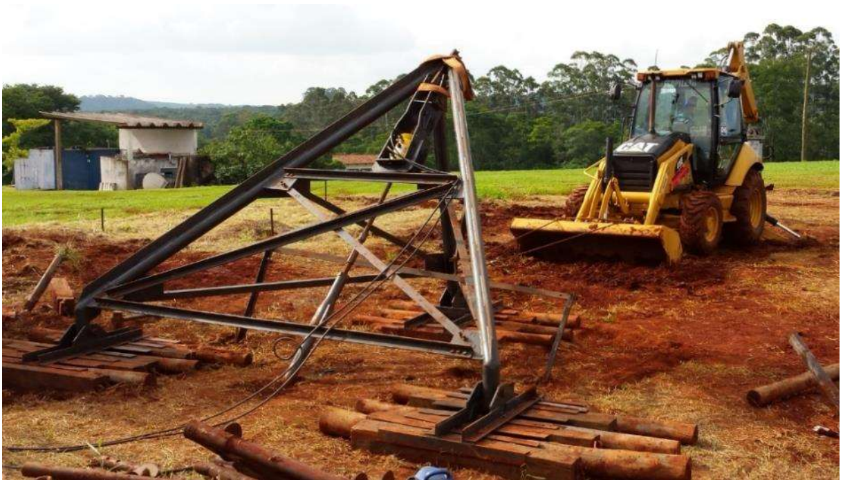
Figura 4.13: Sistema de reação utilizado nas provas de carga à tração em estacas inclinadas.
