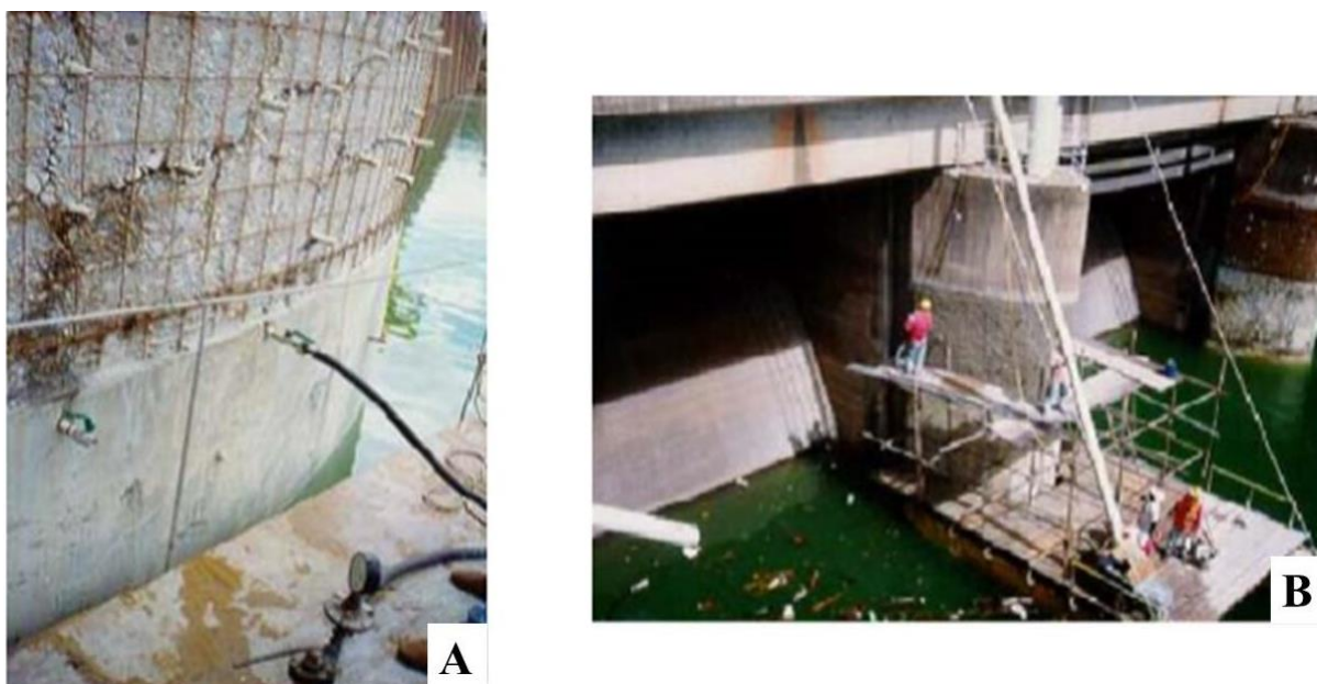
Figura 3.9 - Recuperações nos pilares atacados pela RAS no vertedouro da barragem UHE-FURNAS.
