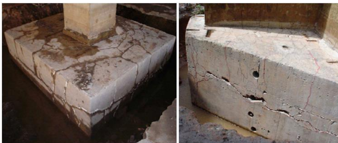
Figura 3.7 - Fissuração em blocos de fundação afetados pela RAA.
