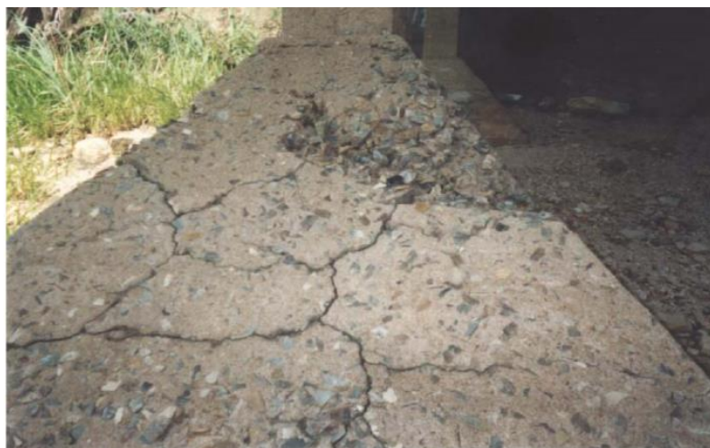
Figura 3.10 – Pilar em concreto armado (visto de cima) da Ponte do Rio Turvo, com fissuras típicas da RAA
