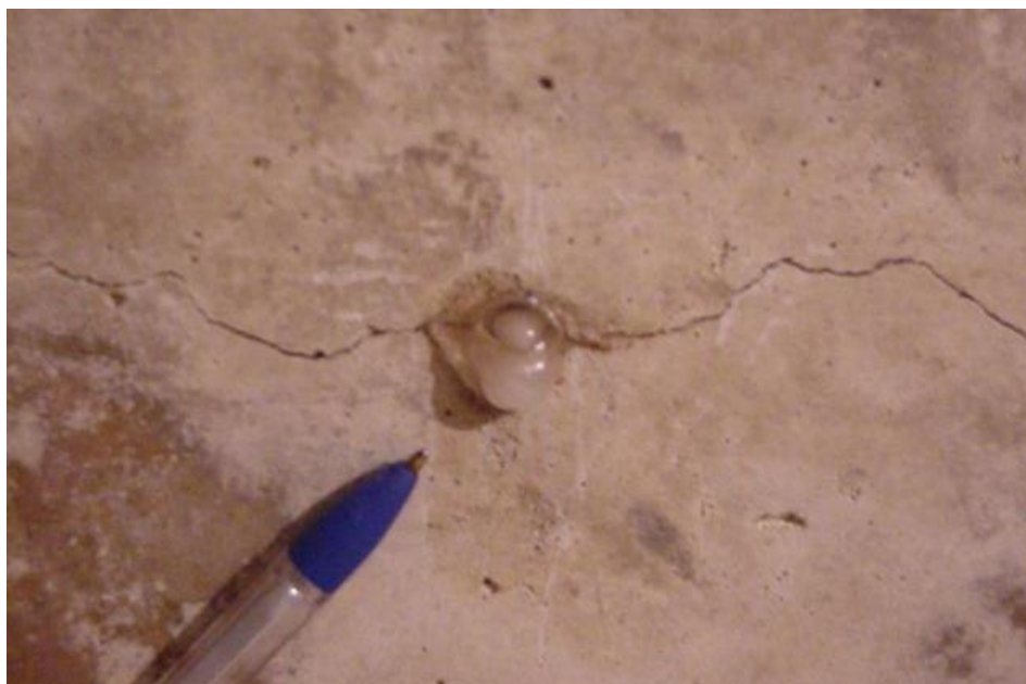
Figura 1.2 - Detalhe do gel exsudado na superfície da estrutura de concreto da UHE-Furnas.
