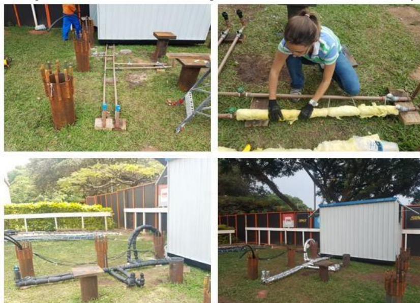
Figura 3. 42- Revestimento usado para o isolamento térmico das tubulações
