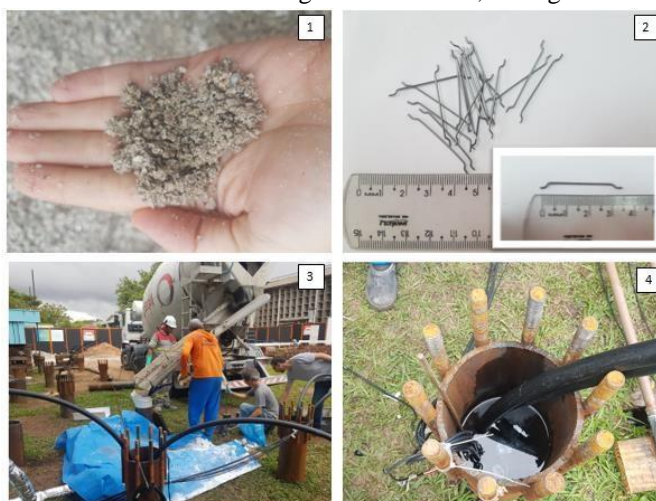
Figura 3. 32- Preenchimentos das estacas piloto com diferentes materiais (1-areia, 2- fibras metálicas adicionadas à argamassa usinada, 3- argamassa usinada e 4- água)
