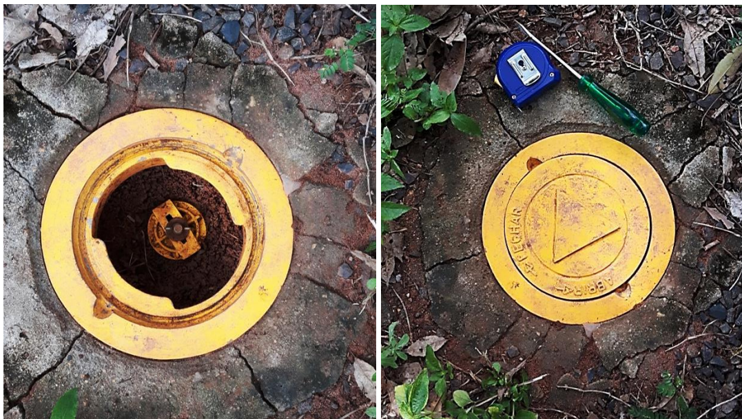
Figura 3.8: Poço de monitoramento: a) detalhe do furo tamponado e, b) proteção do poço contra águas de escoamento superficial e identificação do poço.
