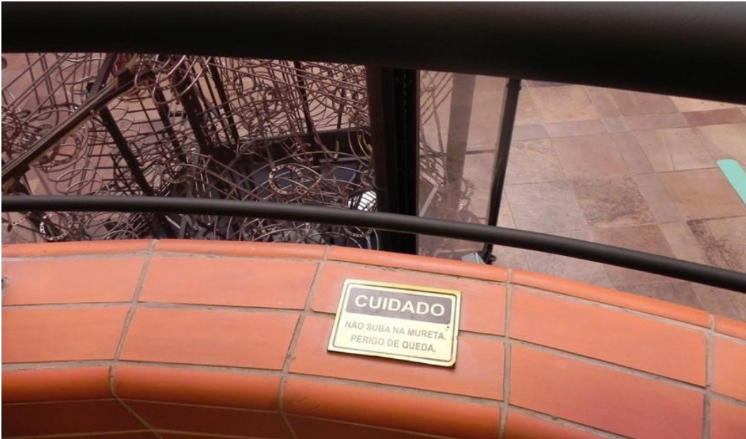
Imagem 217: Sinalização de emergência nas escadas do Museu de Ciências e Tecnologia
