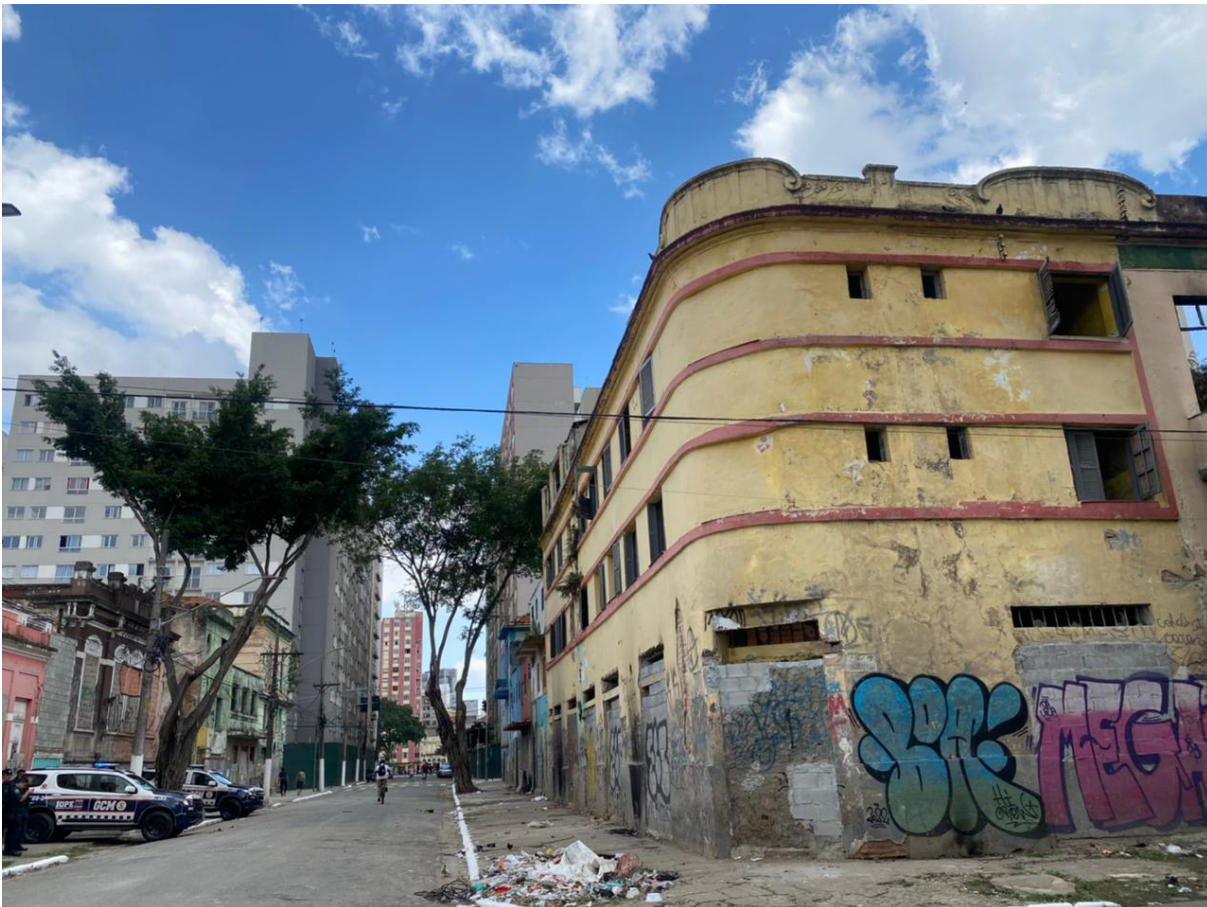
Figura 40: contraste entre a produção imobiliária da PPP Habitacional e os edifícios arruinados da quadra 037 setor 008.
