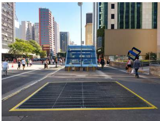
IMAGEM 133 Grelhas de ventilação (insuflamento) da Estação Brigadeiro no nível do passeio.
