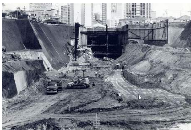
IMAGEM 169 Estação Paraisópolis da Linha 1–Azul do Metrô. Construção pelo sistema de cut-and-cover .
