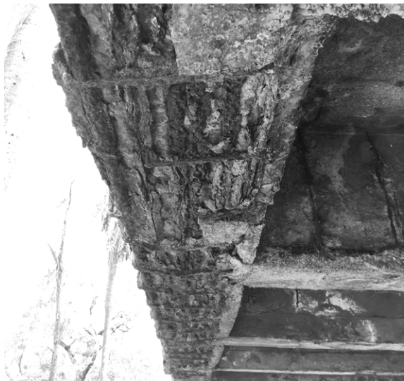
Ferragens expostas sob a viga do pórtico nordeste Foto: Bruno Manso, 2020
