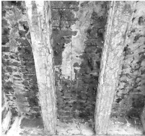
Ferragens expostas sob a laje da cobertura principal Foto: Bruno Manso, 2020
