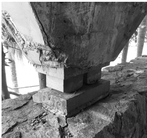
Detalhe das ferragens expostas no pilar nº05 Foto: Bruno Manso, 2020
