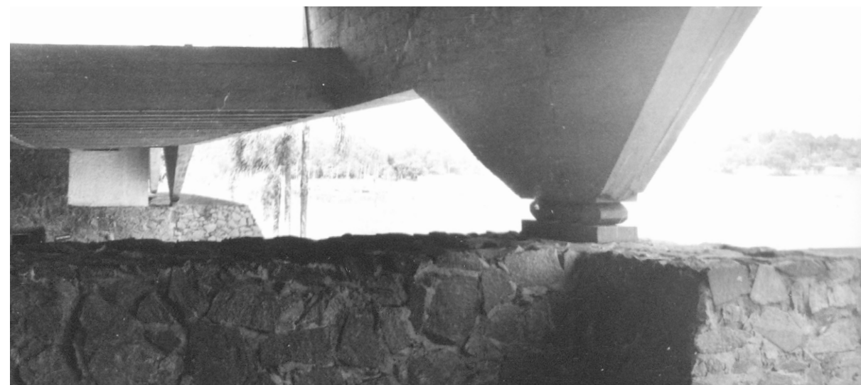
Detalhe do apoio sobre o muro de pedra da garagem de barcos Foto: sem autor e data / Fonte: Acervo da Biblioteca da FAUUSP
