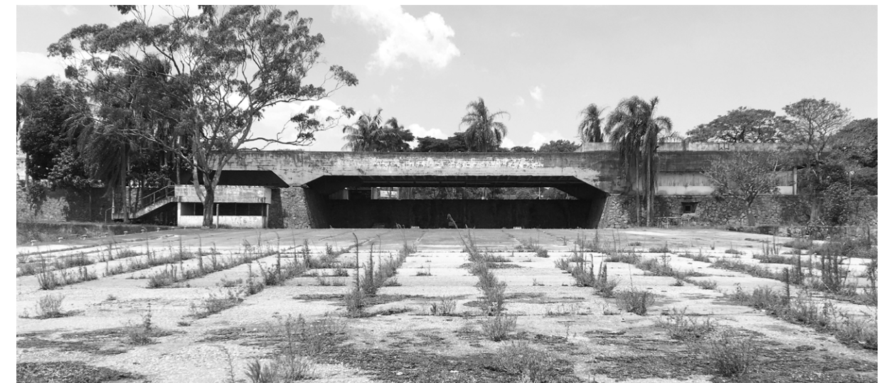
Vegetação que cresce sobre a rampa em vista para elevação sudoeste Foto: Bruno Manso, 2020
