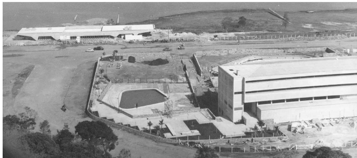
Sede social do Santapaula late Clube em obras - piscinas localizadas no setor sul do terreno Foto: sem autor e data / Fonte: Acervo da Biblioteca da FAUUSP
