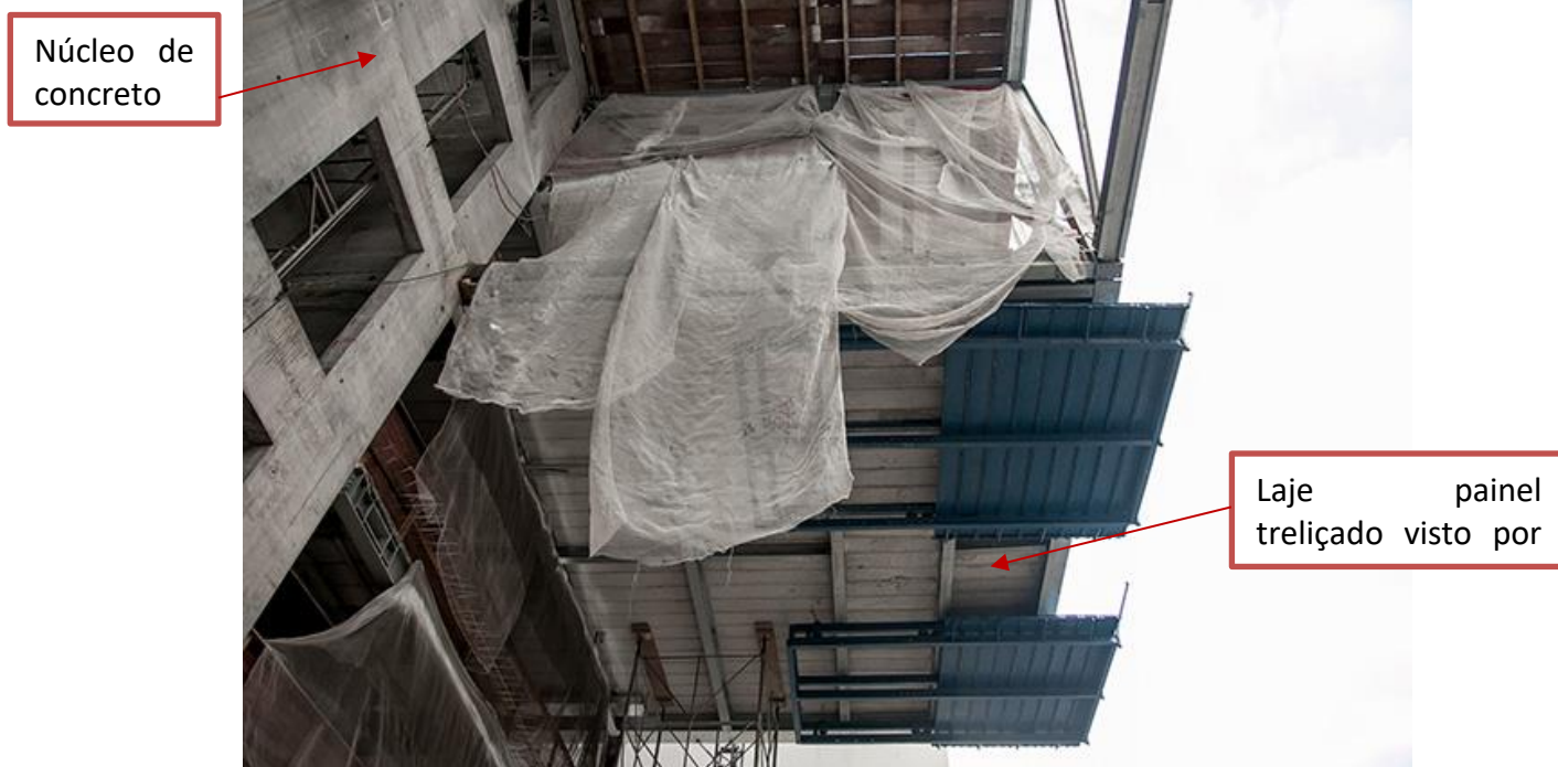
Figura 100 - Laje e estrutura metálica dos pavimentos superiores do IMS (19 de julho de 2016)
