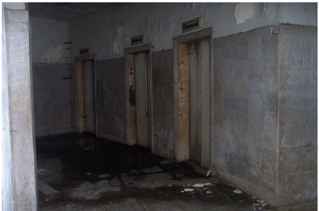
Figura 41 – Antes – Hall dos elevadores quando da vistoria inicial pelo escritório Paulo Bruna A. Associados (Fonte: Imagem cedida por Pedro Bruna)
