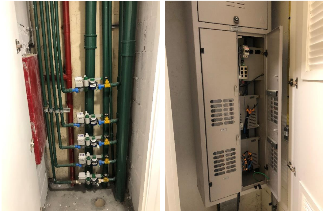
Figura 73 – Quadros de medição remota de energia e água individualizada (Fonte: Nancy Laranjeira, 2022)
