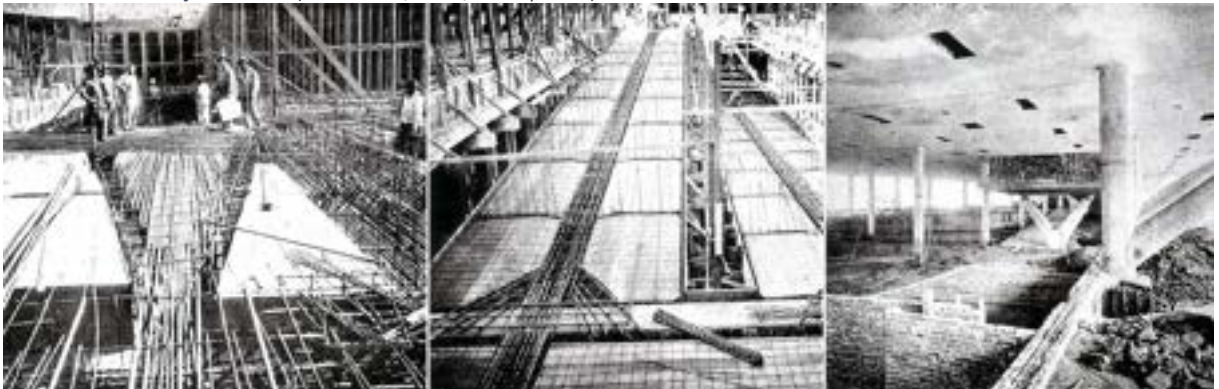
Figura 4-242 – Fotos da construção do prédio: as duas primeiras referem-se à armadura da rampa, a terceira mostra o piso térreo em construção. Fonte: (NIEMEYER, et al., 1953 p. 215)
