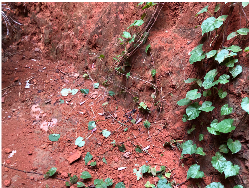
Figura 12. Solo molhado após o deslizamento, com avanço de terra para o quintal
