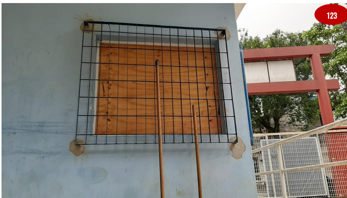
Parque Takebe – Madeira instalada para substituição do vidro danificado na sala da Guarda Municipal. Instalada de maneira provisória, a madeira se mantém no local desde outubro de 2020.
