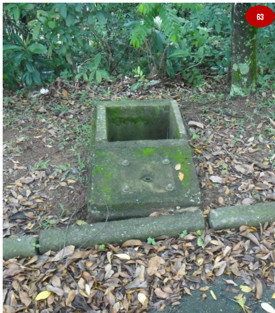
De todo o sistema de iluminação antes existente no Pousada dos Jesuítas, restaram somente as caixas de passagem de fiação.
