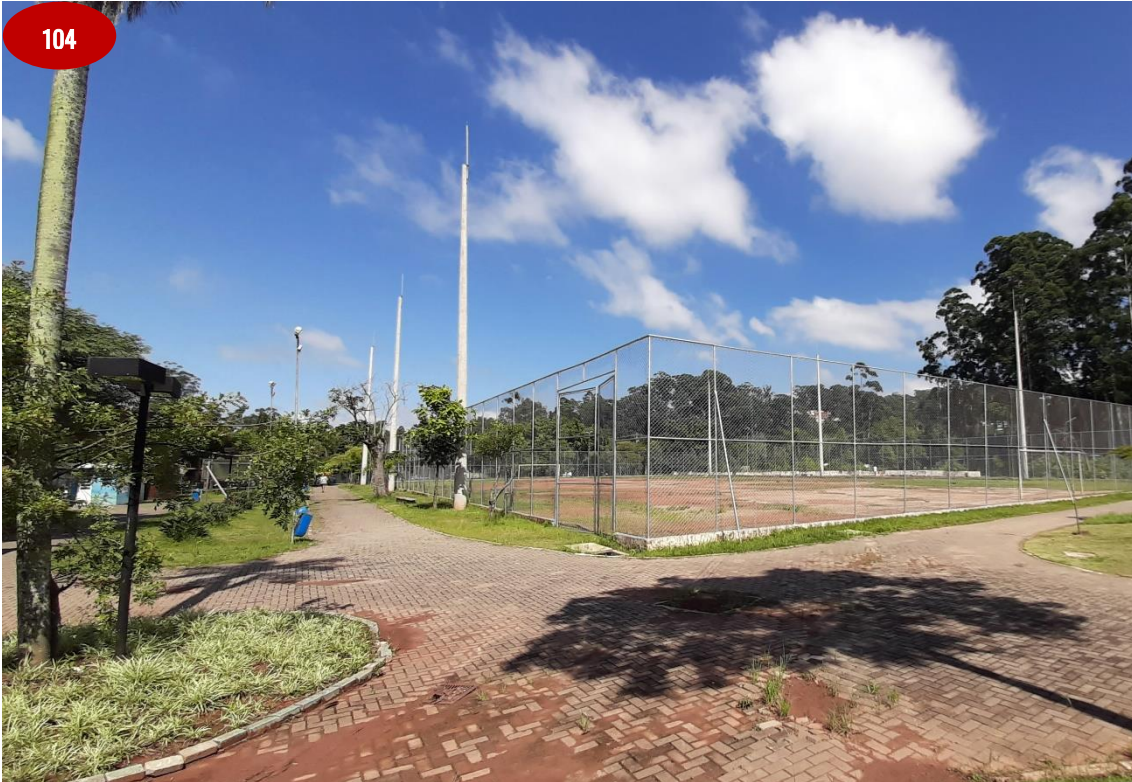
Imagem parcial da pista de caminhada – observa-se deficiência em relação a drenagem do local resultando no acúmulo de sedimentos provenientes dos canteiros.
