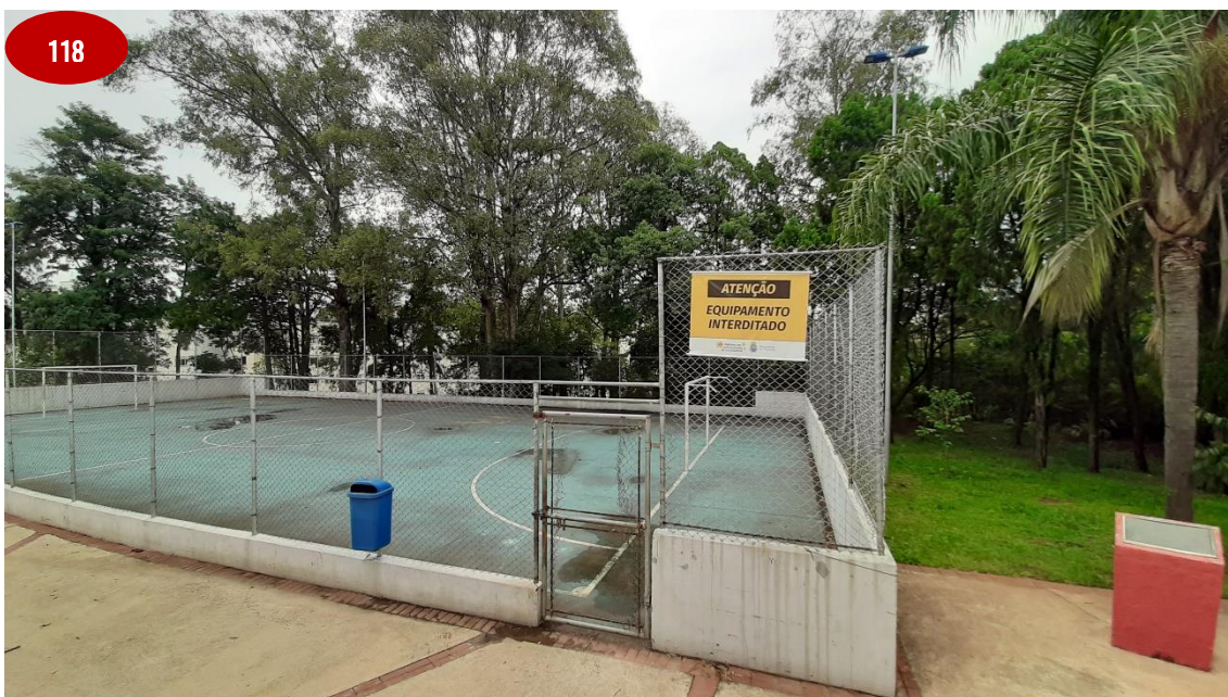
Quadra esportiva – devido à interdição do equipamento durante a pandemia, parte do alambrado do portão foi retirada para acesso ao local pelos frequentadores do parque aos finais de semana.
