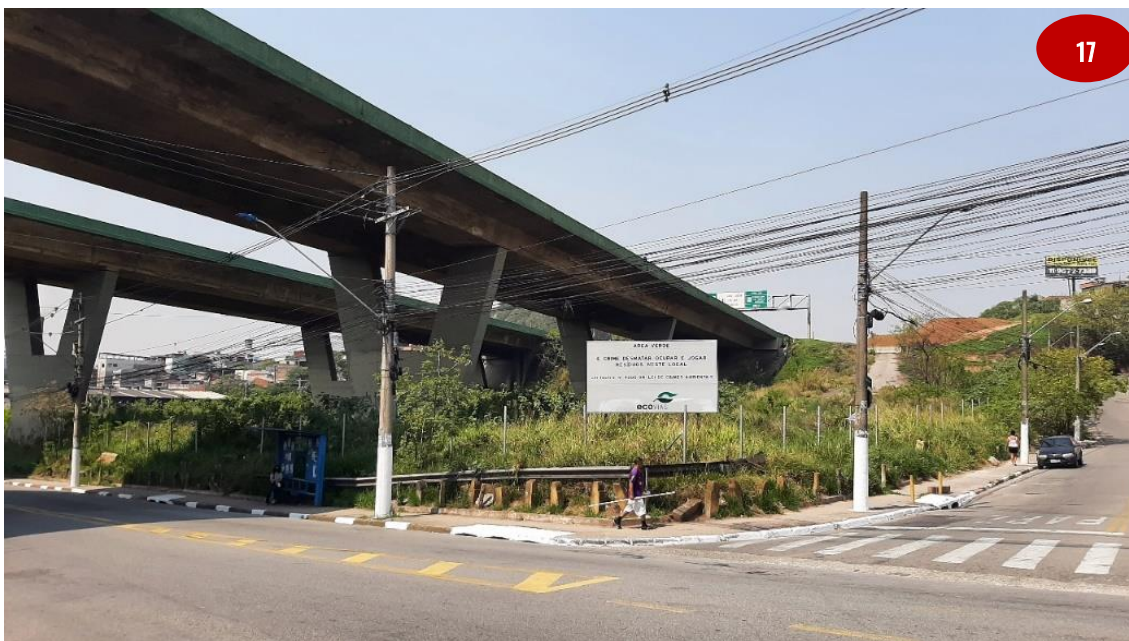
Rodovia dos Imigrantes. Pontilhão na região de Serraria e espaço livre existente sob este (sem uso).
