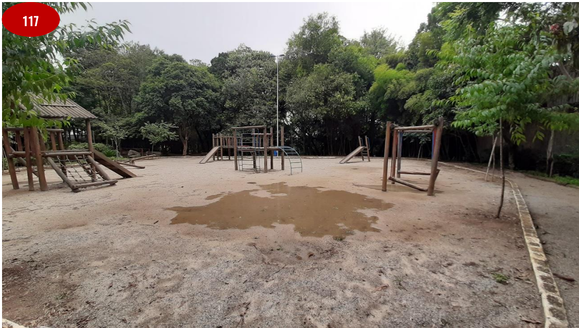
Playground do Parque Takebe. Observa-se uma deficiência em relação à drenagem e do local, além de alguns equipamentos danificados.
